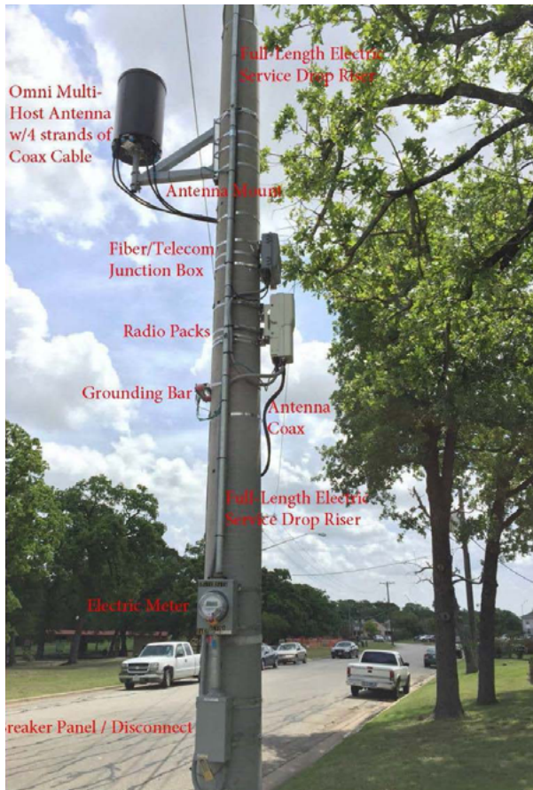
Exemple d'une municipalité expliquant l'installation d'une small cell à ses administrés, États-unis
